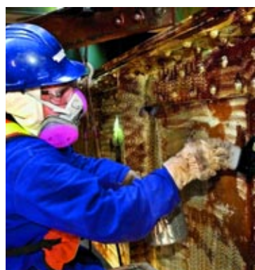
Le décapage et le scellage des boulons nécessitent un travail minutieux au pinceau
